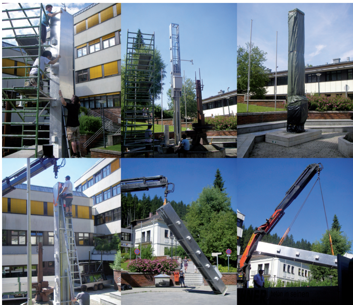
Abb. 5 Vorbereitungen zum Abtransport des Liftes vom Standort HTL Waidhofen/Ybbs: Abnahme der Verkleidungen; ein letzter Funktionstest, der Lift ist vollständig ausgefahren; METLIFT ist verpackt und wartet auf den Transport (oben, v.l.). Abtransport des Liftes von der HTL Waidhofen/Ybbs: Der Lift wird am Kran befestigt und auf dem Vorplatz umgelegt. Nach Umhängen der Befestigungsgurte erfolgt die Verladung auf den LKW (unten, v.l.).
